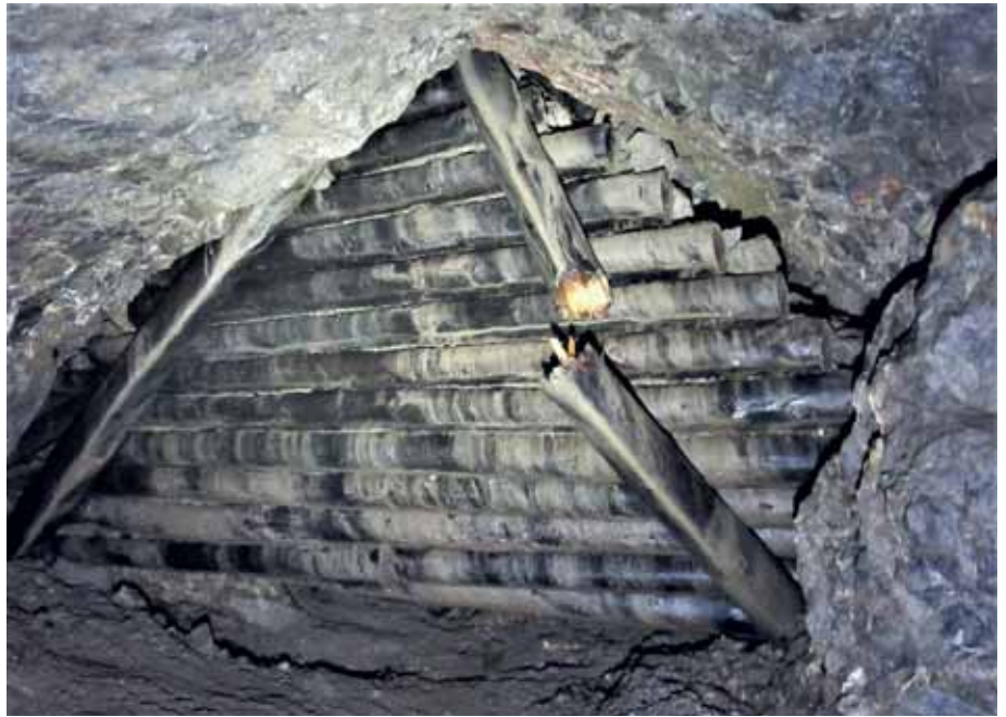
05 Trägerbruch an der 1970 eingebauten Lichtlochverbauung, Stand 2015
