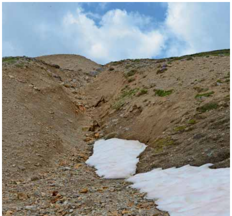
06 Haldenabstützung am eingebrochenen Mundlocheinschnitt (Bild Elsbeth Rehm)
